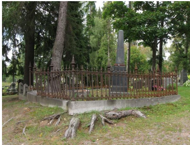
Kuva 24 Väärään paikkaan istutetut puut ovat vahingoittaneet kasvupaikkansa rakenteita.
