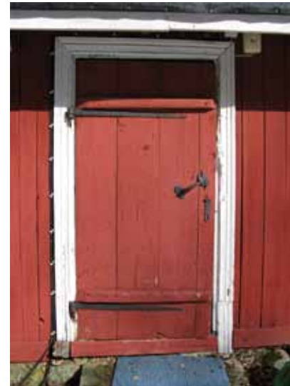
Kuvat 4-6: Purettavan piharakennuksen yksityiskohtia
