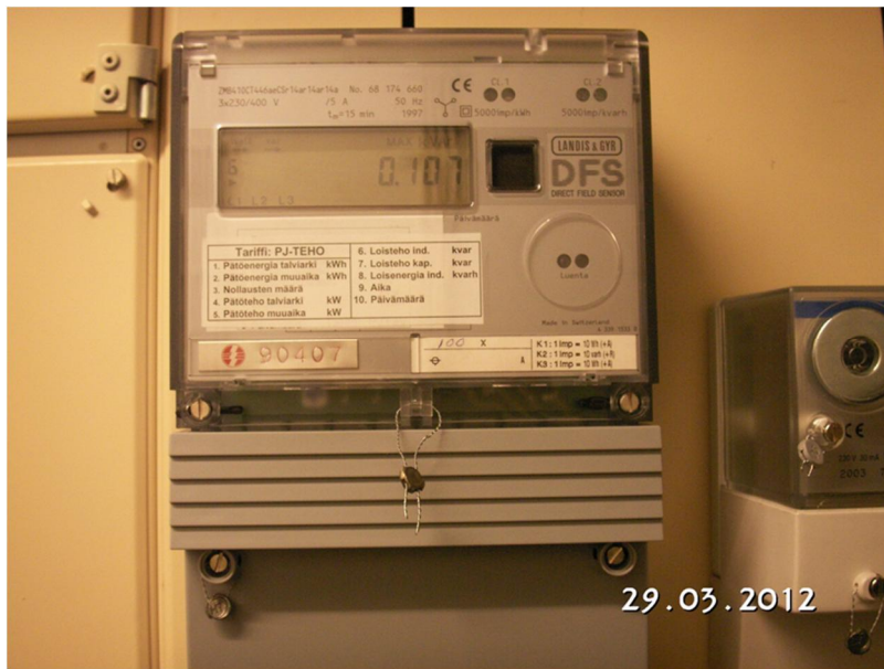
Kuva 11. Etäluettava kWh- ja kVar –mittari
