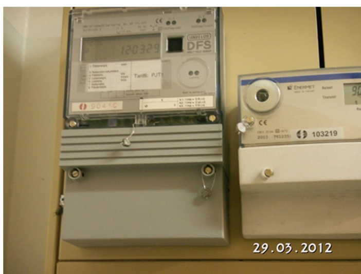
Kuva 14. Päämittari: Kwh- ja kVar –mittari
