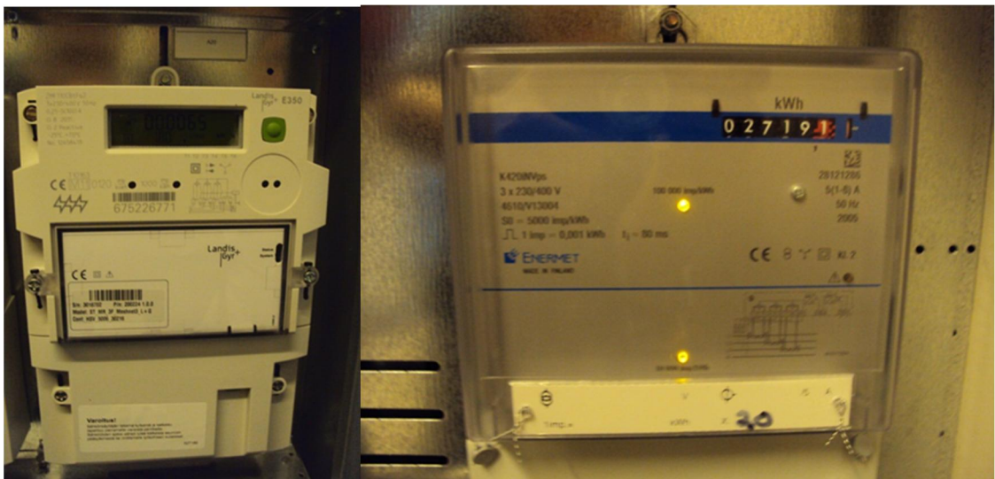
Kuva 12. Etäluettavat huoneistomittarit sekä keittiön kWh-mittari
