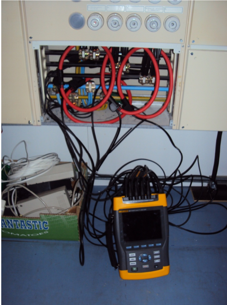
Kuva 8. Elimäen palvelukeskuksen mittauskytkentä
