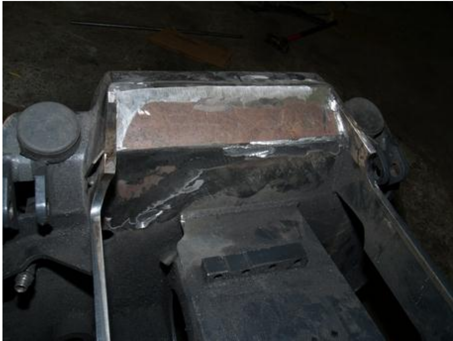
Kuva 27. Öljysäiliön jättämä reikä paikattuna. (Kuva: Timo Ihalainen.)
