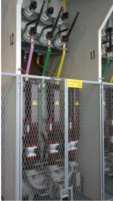
KUVA 26. BBC paineilmakeijoston kenno jossa katkaisija ja erotin
