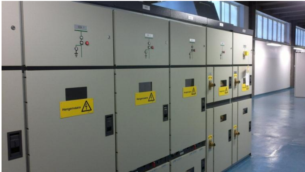
KUVA 29. Nykyaikainen kojeisto, jossa 10 kV tyhjökatkaisijat
