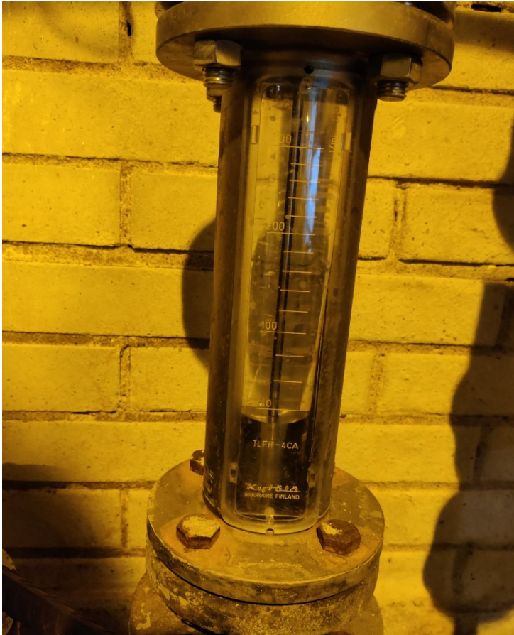
KUVA 16. Laimennusveden rotametri virtauksen mittaukseen
