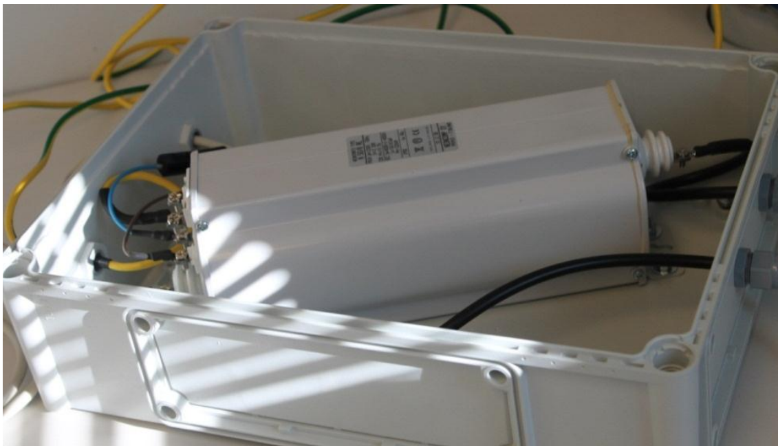
Kuva 25. Muuntaja oli koteloitu turvallisuussyistä ja se säilytettiin lukitussa tilassa kokeiden välillä.
