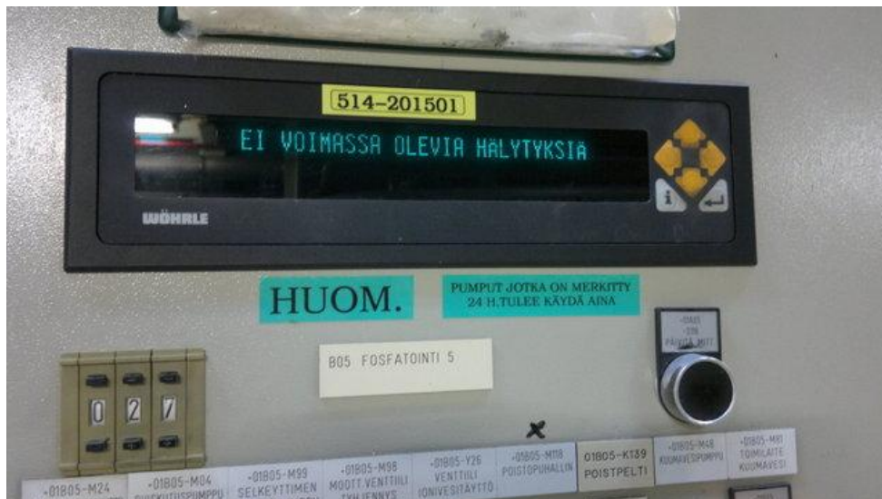
Kuva 23 Esikäsitteilylaitoksen sähkökaapeissa olevat operointipaneelit
