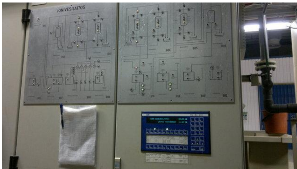
Kuva 25 Operointipaneeli ja yläpuolella oleva prosessikaavio
