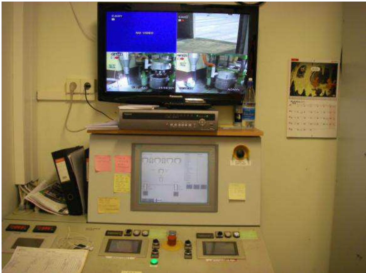
Bild 5: Klassisk styrpulpet inne i styrbunkern.
