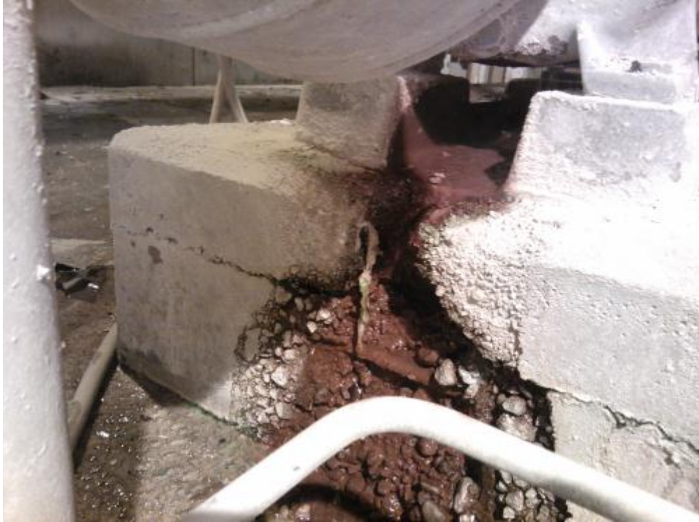
Kuva 10. Lauhdevuodon aiheuttama eroosio lauhdepumpun pedissä
