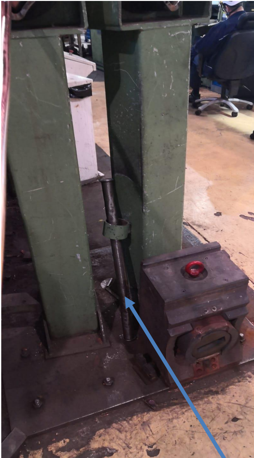
Kuva 4. Raaka-aineen oikaisuputki (yksinkertainen teräsputki).
