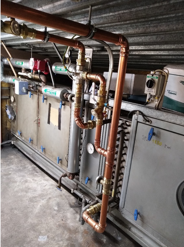
KUVA 22. IV-koneen jäähdytyspatteri ja siihen liittyviä putkistoa varusteineen
