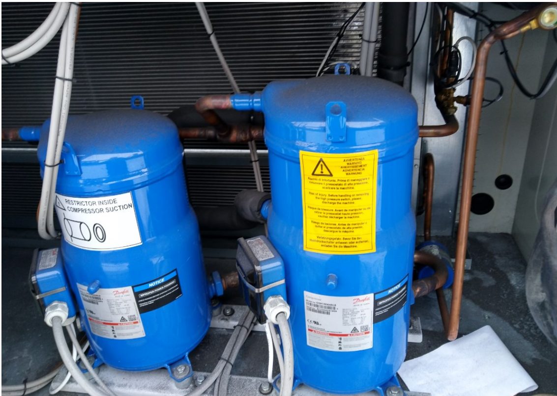
KUVA 3. Tämän projektin vedenjäähdyttimen scroll-kompressorit tandem-kytkennällä.
