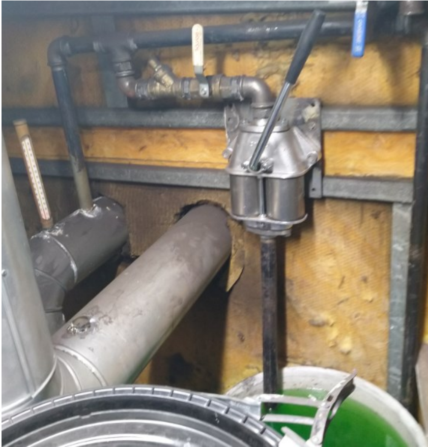
KUVA 20. Alkuperäistä putkistoa ja käsikäyttöinen täyttöpumppu
