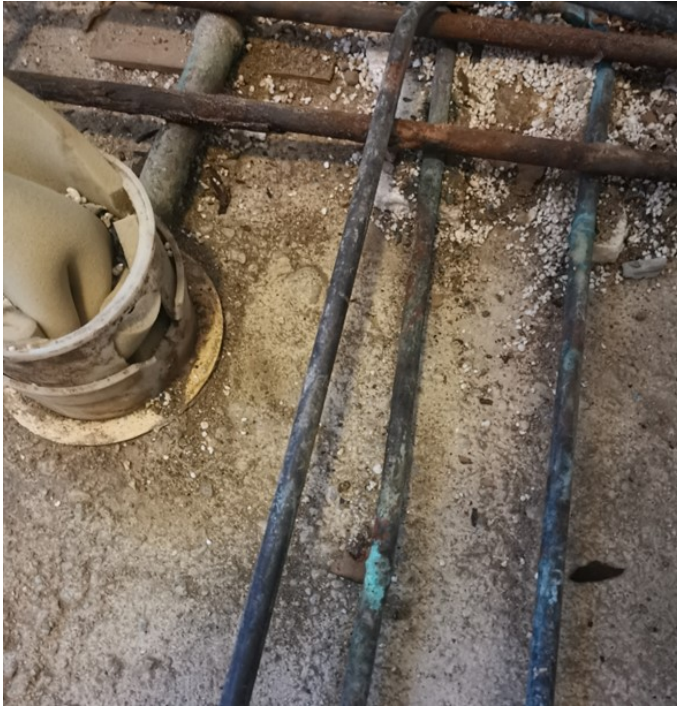
Kuva 7 Epätiivis lattiakaivo (henkilökohtainen tiedonanto, Teppman Oy)
