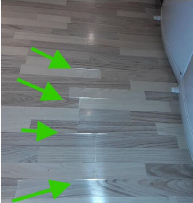
Kuva 24 Jääkaapin edustan turvonnut lattia (henkilökohtainen tiedonanto, Teppman Oy)
