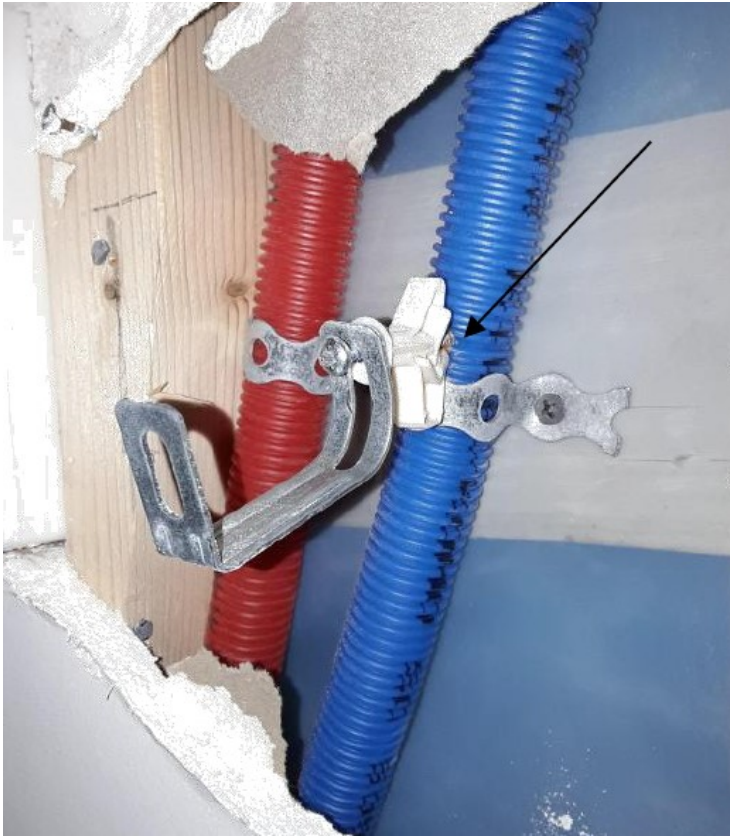
Kuva 34 Kalusteen kiinnike suoraan käyttövesiputkeen ruuvattuna (henkilökohtainen tiedonanto, Teppman Oy)
