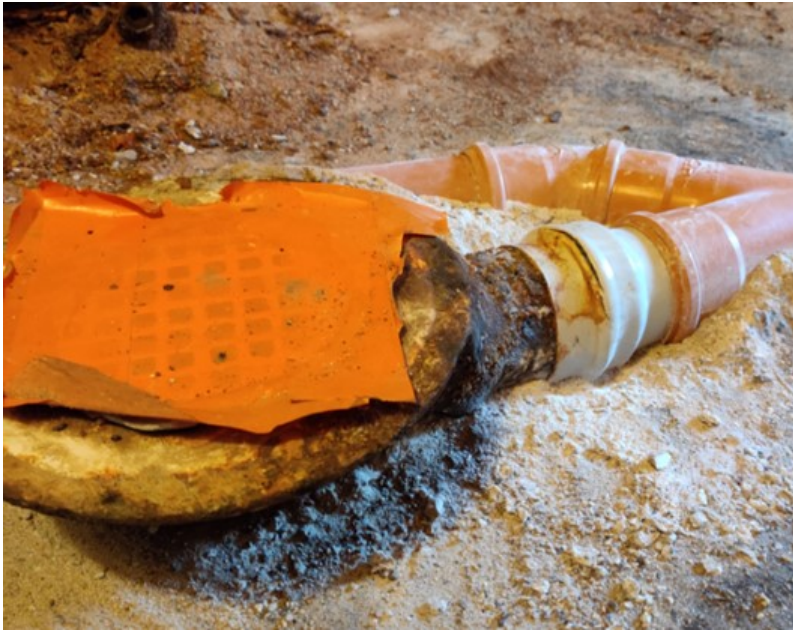
Kuva 8 Valurautaisen lattiakaivon liitos muoviviemäriin pettänyt (henkilökohtainen tiedonanto, Teppman Oy)
