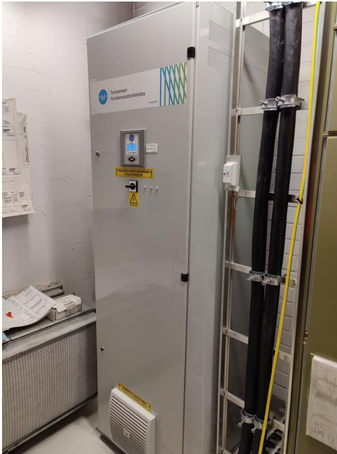
Kuva 8. PKE1:een kytketty lattialla seisova estokelaparisto, QE1.
