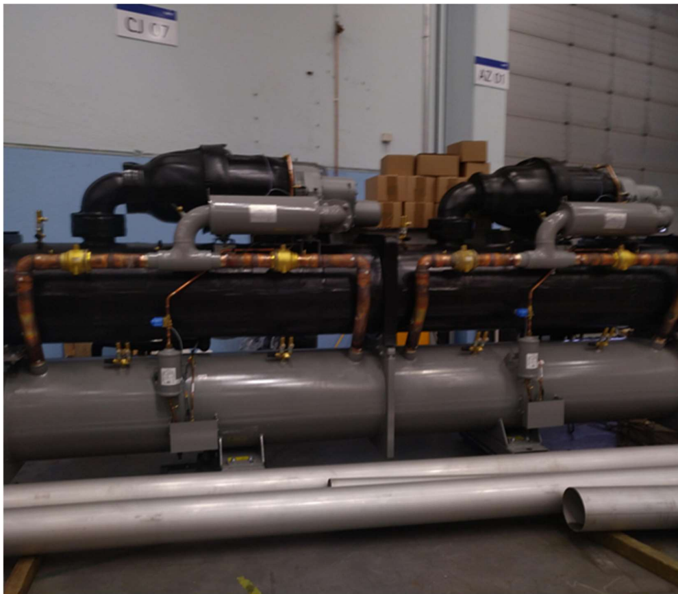
Kuva 6. Kohteen lämpöpumppu ennen asennusta.
