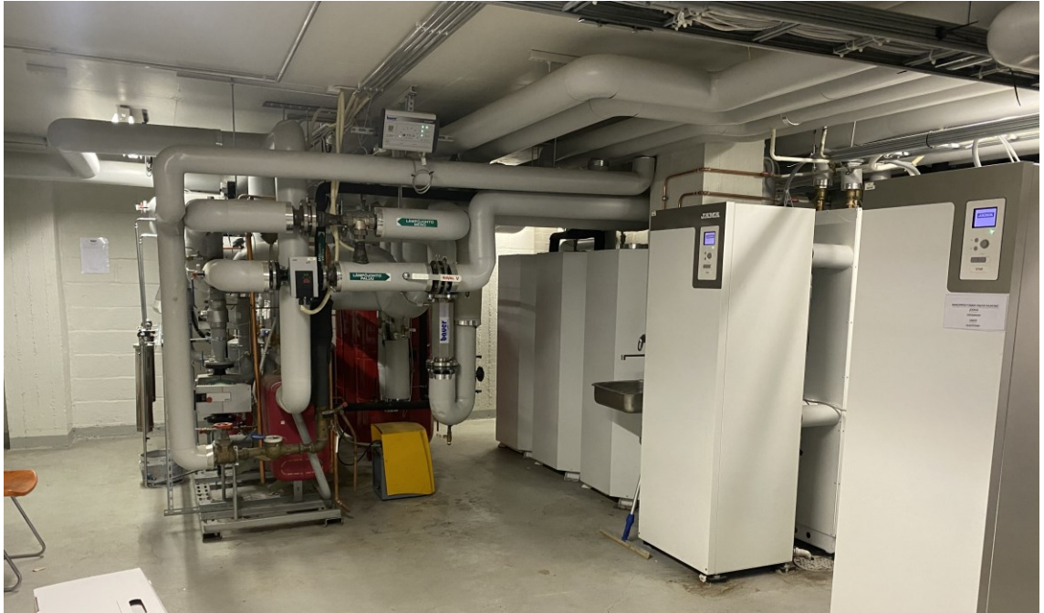
Kuva 15. KOy Irmelinpesä, lämmönjakuhuone.
