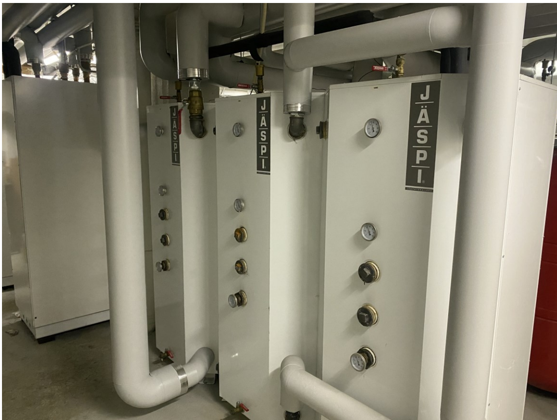
Kuva 20. Käyttöveden varaajat ja lämmityksen puskurivaraaja
