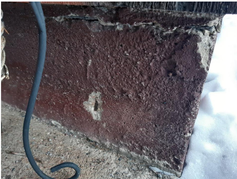
KUVA 6. Betoniraidoitteiden korroosion aiheuttamaa betonin lohkeilua.
