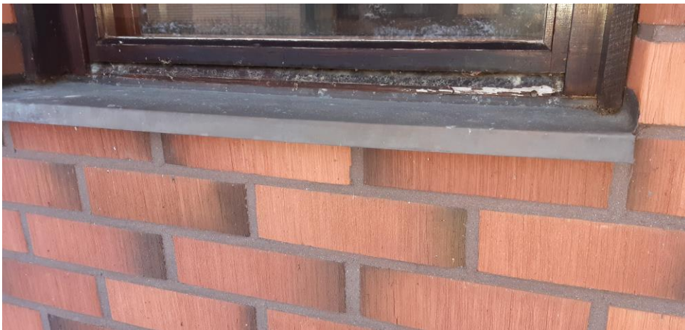
KUVA 11. Ikkunapellitykset ovat yksittäisissä ikkunoissa liian loivassa kulmassa.
