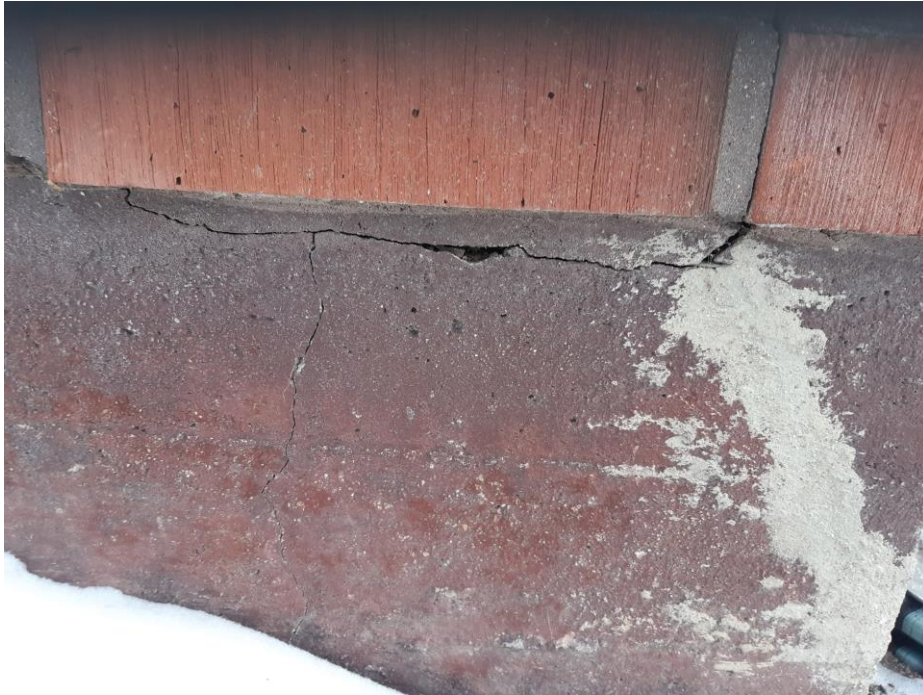
KUVA 7. Halkeama perustuksissa. Halkeama johtuu todennäköisesti painumasta.
