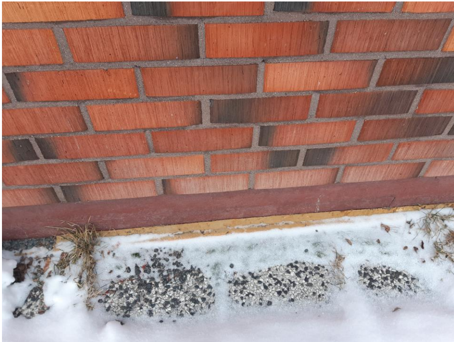
KUVA 5. Sokkelin eristeet ovat paikoin näkyvissä.
