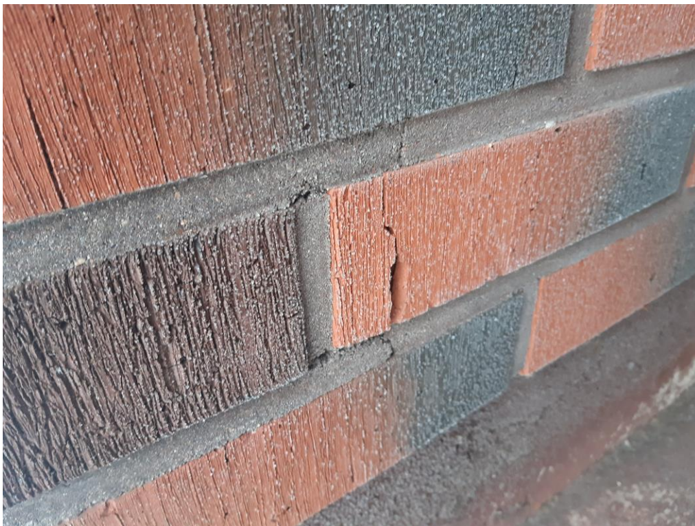
KUVA 3. Pieni vaurio tiilimuurauksessa.
