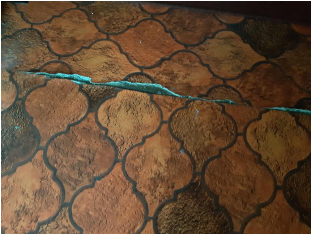
KUVA 13. Lattiamatot ovat saumakohdista vaurioituneet.
