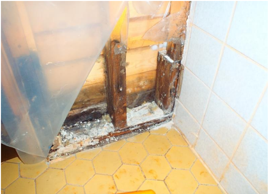
KUVA 6. Kosteusvaurio märkätilan laatoitetussa seinässä. Kuva ei ole opinnäytetyön kuntoarvion kohteesta. (1970-luvun talo)
