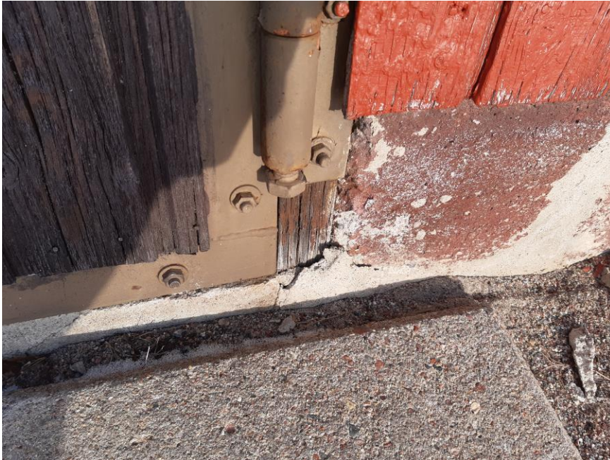
KUVA 10. Autotallin oven karmit ovat alaosista osittain vaurioituneet.
