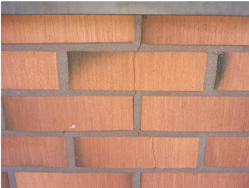
KUVA 2. Halkeama tiilimuurauksessa. Halkeama on mahdollisesti aiheutunut painumisesta.
