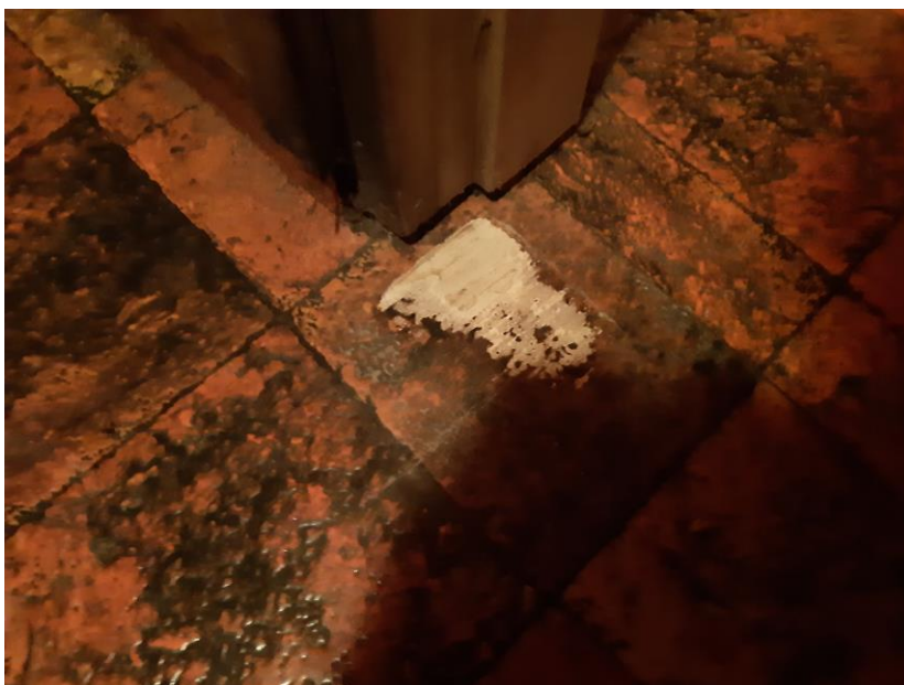
KUVA 16. Löylyhuoneen ovi on vaurioittanut lattiamattoa.
