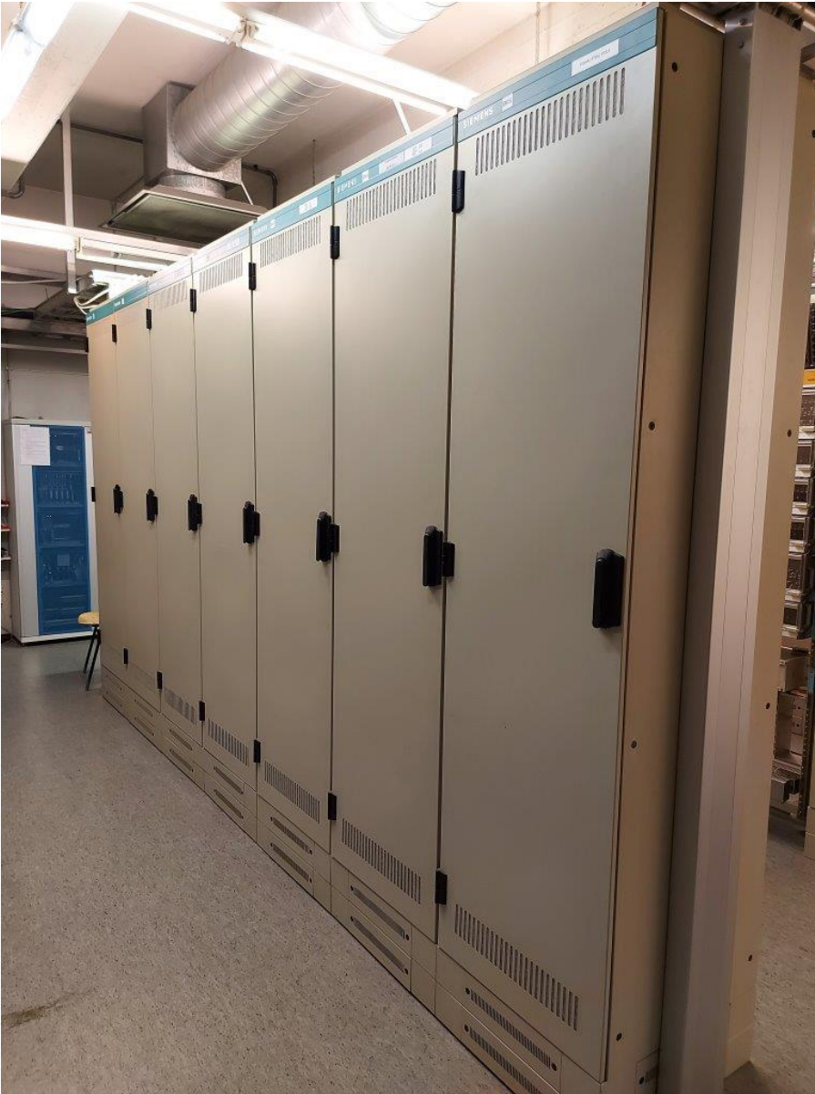
Kuva 7. Siemens Simis-C-alueasetinlaite, päätietokoneet
