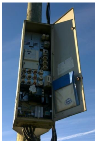
Figur 10. Central monterad på en stolpe
