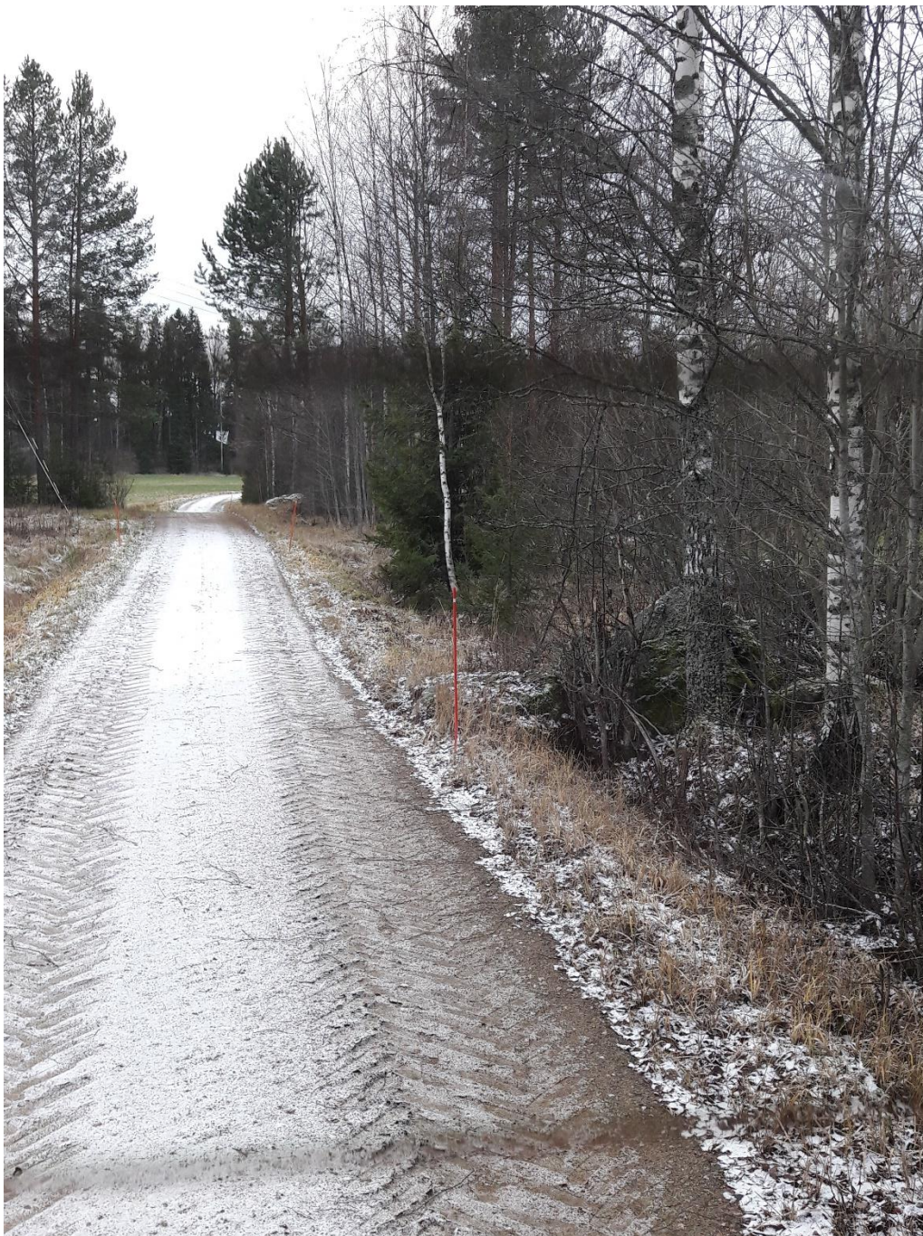
Maakivi ojassa estäen ojan toiminnan. Paalu 3900.
