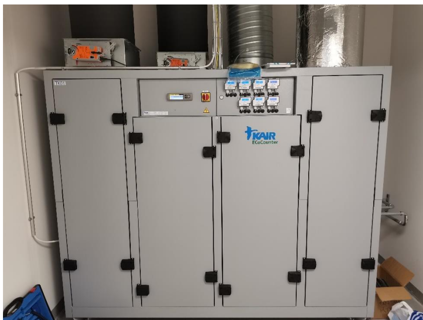
Kuva 21. Kohteen ilmanvaihtokone, jossa mittaus- ja säätötyö suoritettiin
