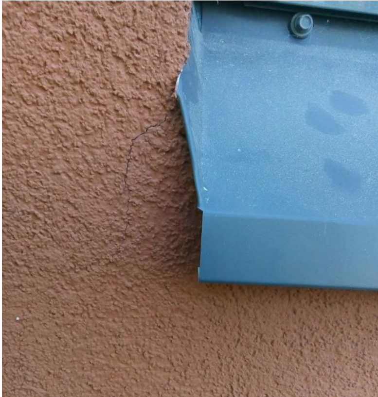
Kuva 24. Ikkuna-aukon nurkan halkeama [5, s.27.]
