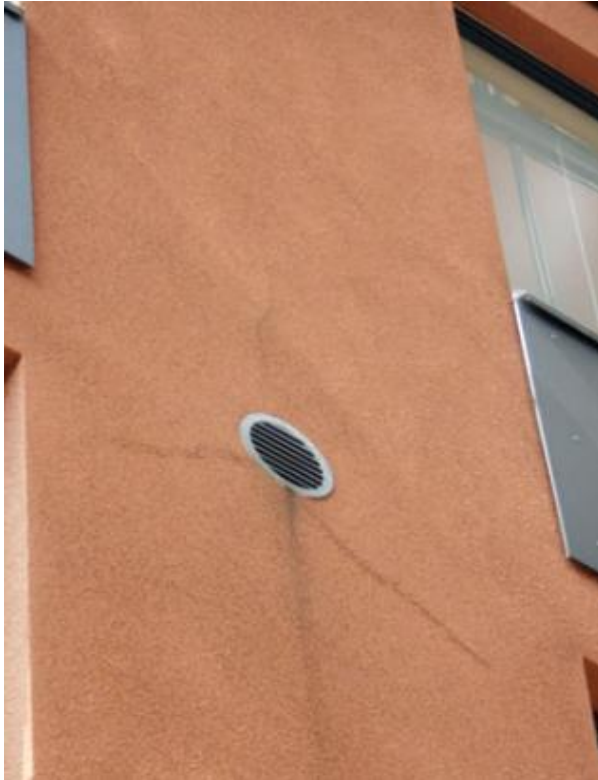
Kuva 8. Läpiviennin kohdalla havaittavaa rappauksen halkeilua [5, s. 31.]
