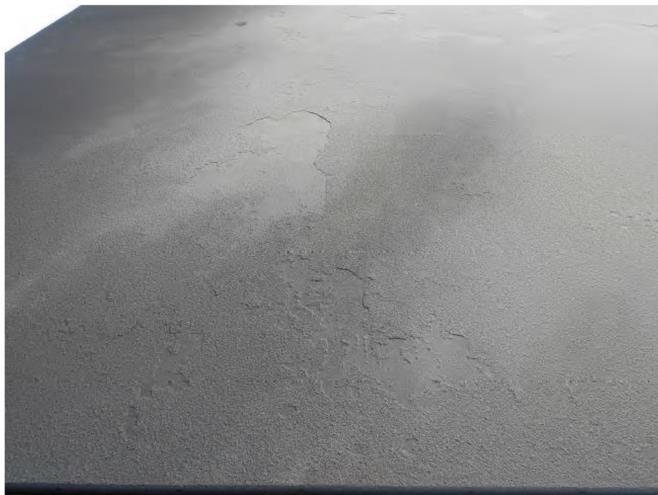
Kuva 11. Pintarappauksen irtoamista [5, s. 33.]
