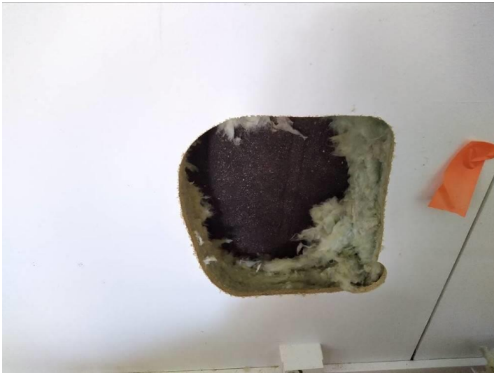
KUVA 3. Ulkoseinäavauksesta löydettiin bitumihuopaa hirren sisäpinnasta
