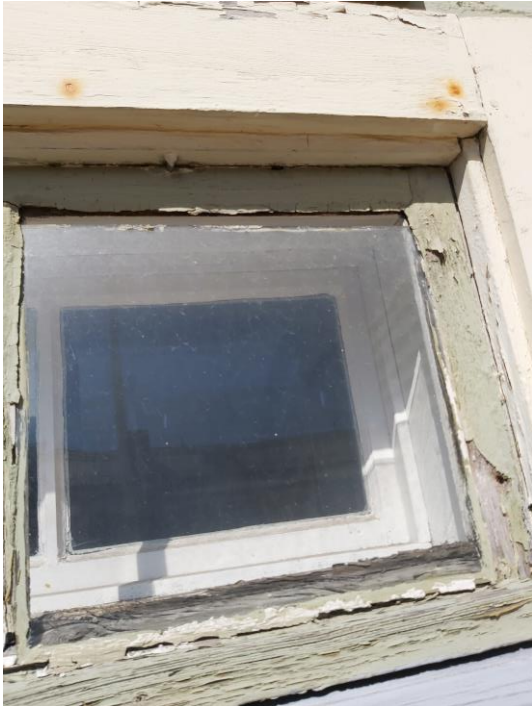
KUVA 11. Ulko-oven yläpuoliset ikkunat ovat erittäin huonokuntoisia
