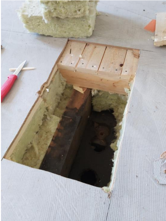
KUVA 5. Alapohja-avauksesta löydettiin niskojen pinnalta tervaa
