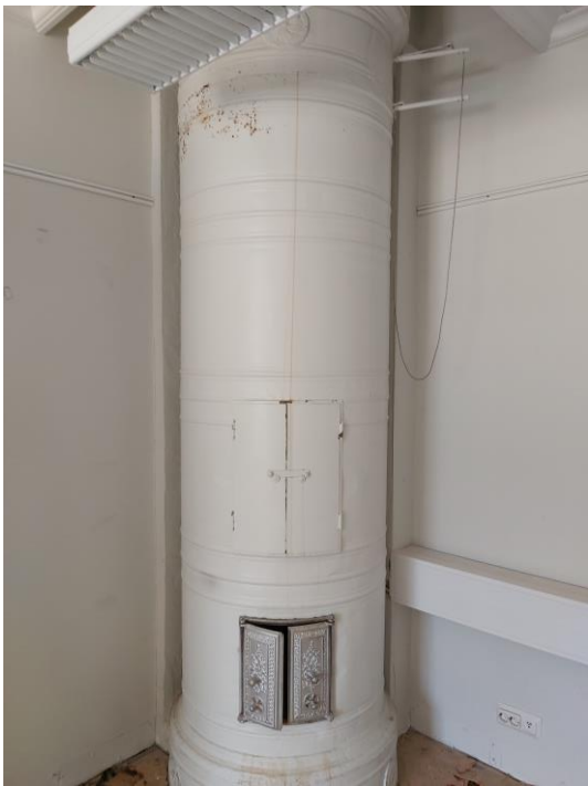
KUVA 19. Pönttöuunin yläreunassa oli havaittavissa ruostetta
