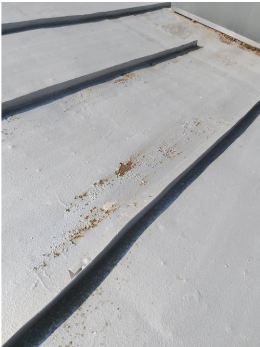
KUVA 17. Vesikatteessa oli havaittavissa paikoittain pientä ruostumaa
