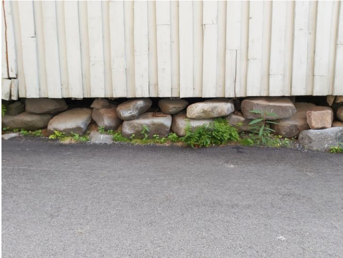
KUVA 10. Takapihan puolella kiviladelmassa oli isoja aukkoja
