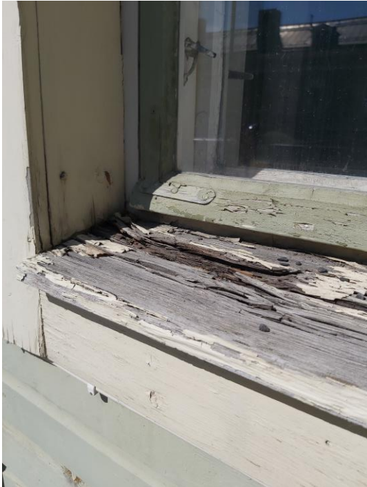
KUVA 12. Tilan 115 ikkunalaudassa lahovauriota
