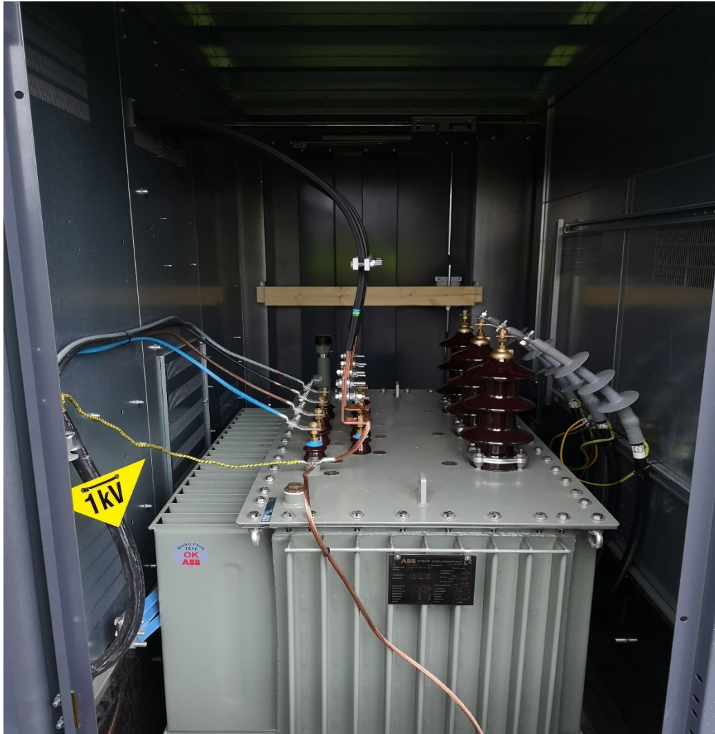
Kuva 15. Muuntajatila ja muuntajakone
