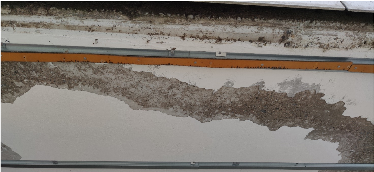
Kuva 6. Laatan alapuoliset vauriot.
