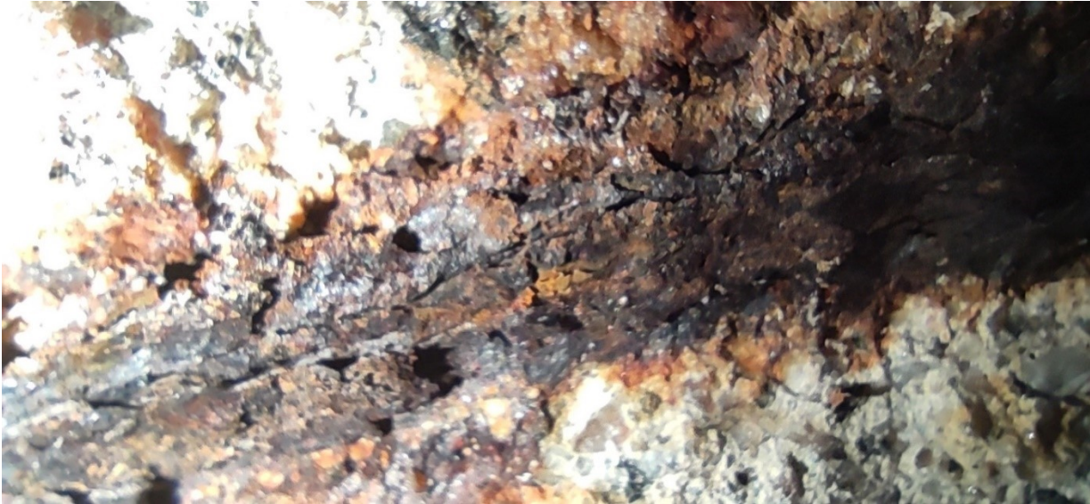
Kuva 9. Korroosio on muuttanut lähes koko teräksen ruosteeksi.
