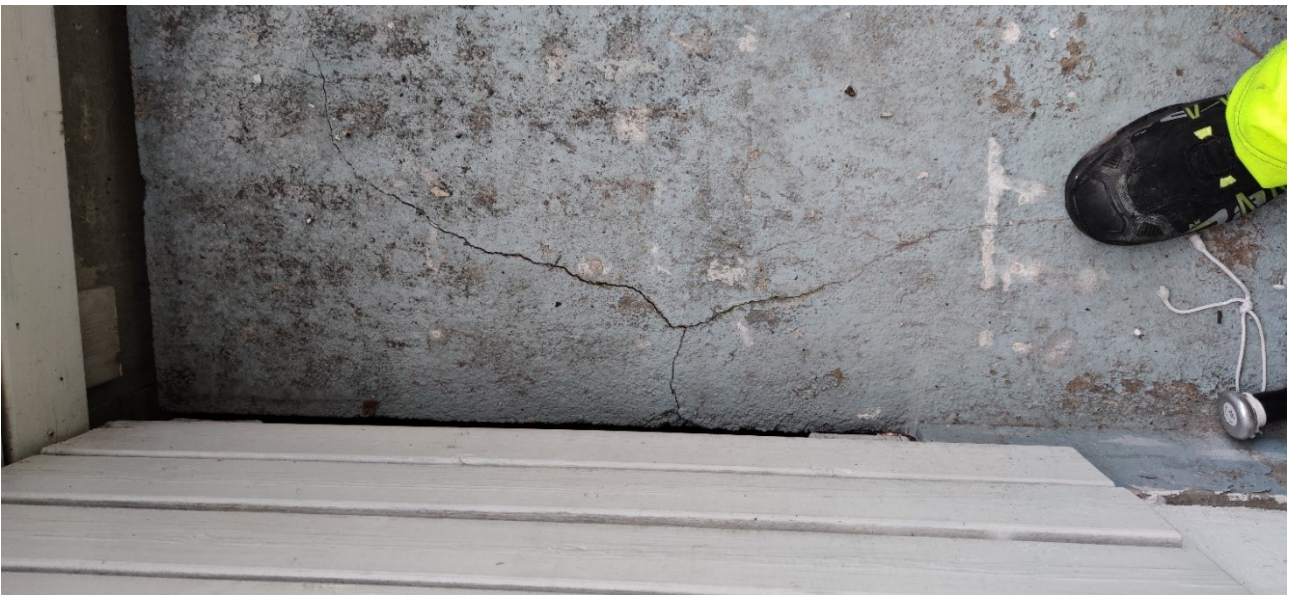
Kuva 8. Pintavalussa oleva halkeama.
