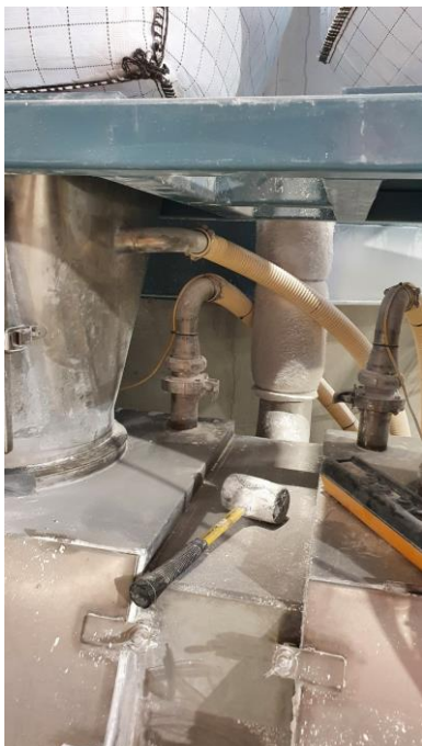
Kuva 3. Pölynpoiston putkisto ja paineenpoisto suodatin.
