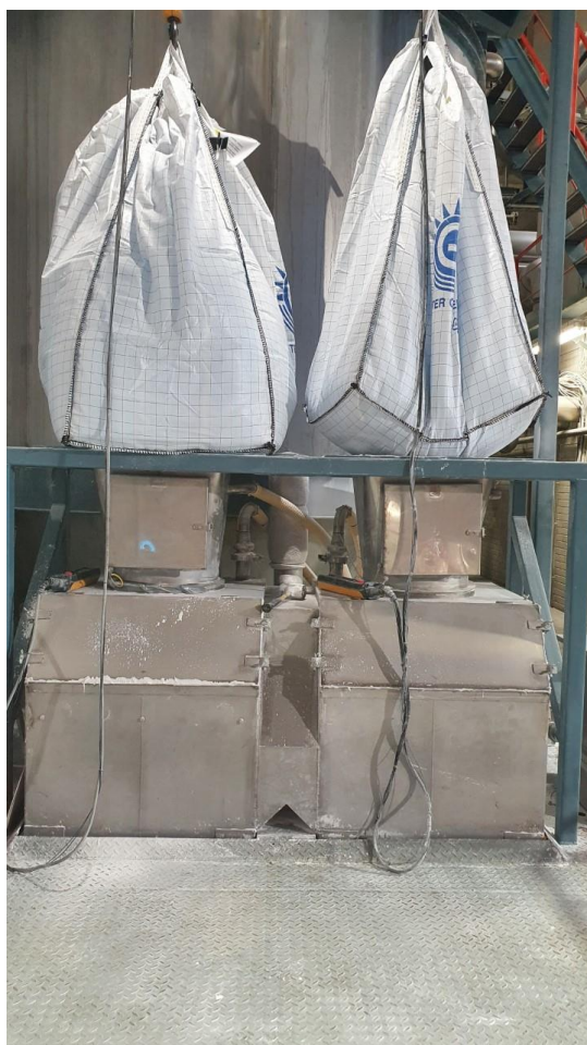
Kuva 2. Naantalin tehtaan lisäaineasema.
