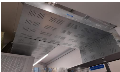
Kuva 27. Kiskosilta muuntajalta sähköpääkeskukselle.
