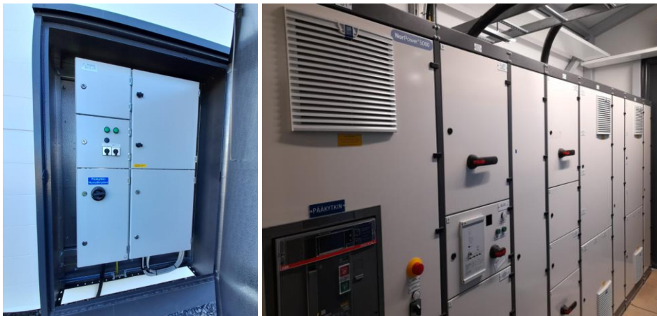
Kuva 26. Sähkönjakokeskus ja sähköpääkeskus.
