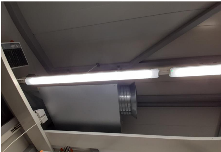
Kuva 25. Sähkötilan valaistus ja lämmitys.
