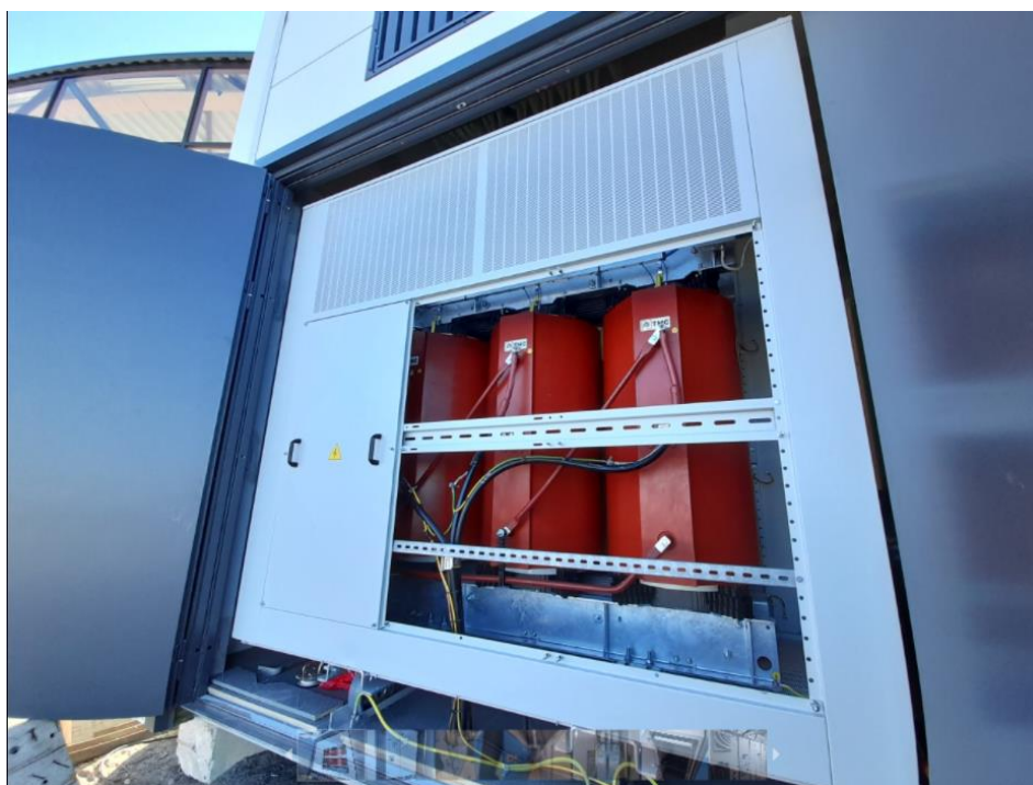
Kuva 28. Sähkötilaan sijoitettu 2,5 MVA koteloitu jakelumuuntaja.
