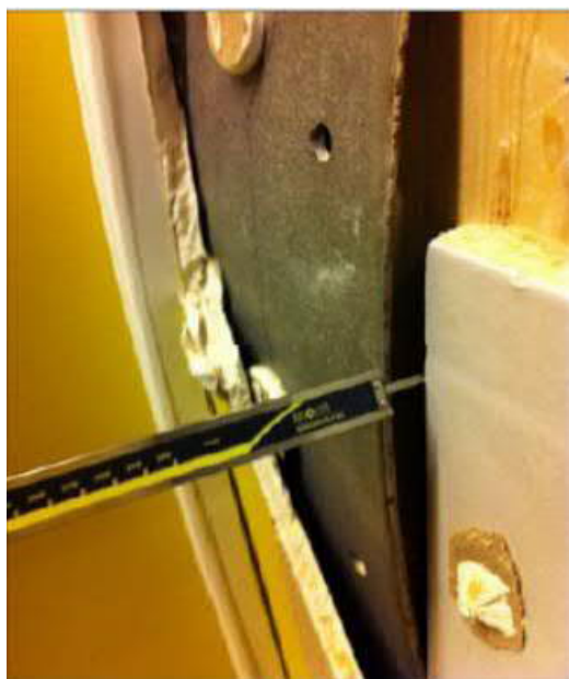
KUVA 2. Nurjahtanut lattateräs CLT-levyjen välisessä liitoksessa (Lahtela 2018b)
