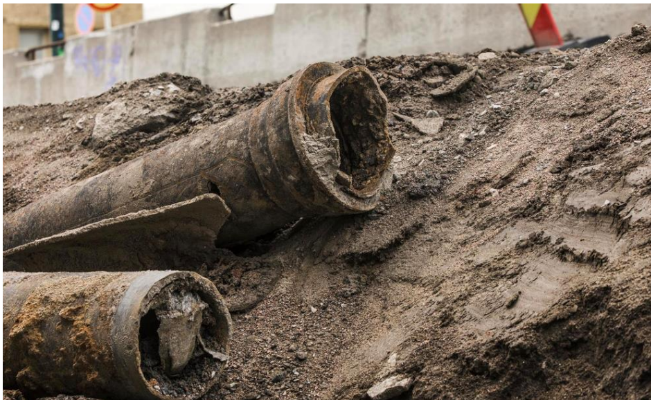
KUVA 5. Tsaarinaikainen 130-vuotias runkovesiputki (HS 2019)
