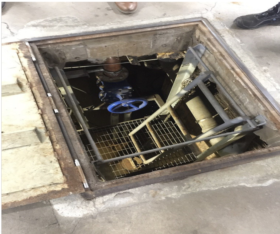
Kuva 13. Pumppaamossa ei ole kovin paljoa tekniikkaa kokonaisuutena ja se on melko toimintavarmaa. Yksi pumppaamo aiheuttaa normaalisti hälytyksiä ei yhtään tai vähän.
