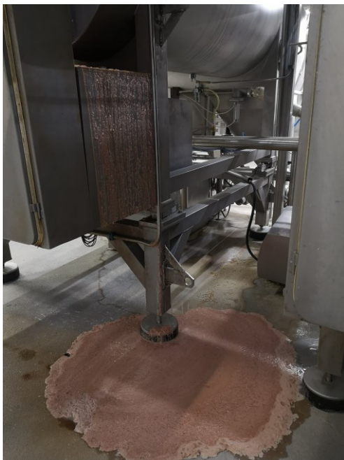
Kuva 15. Viimeisellä havainnoinnilla havaittu vuoto.
