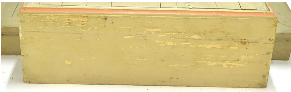
Kuva 9. Maalivauriot kateederin korokkeessa (Lankiala 2020)
