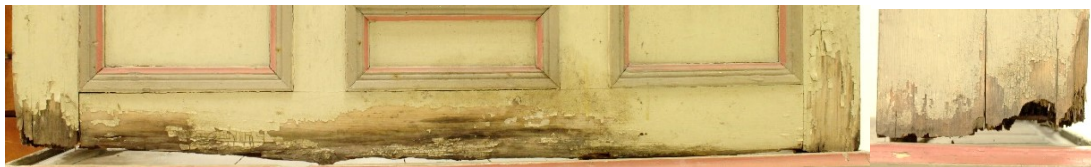
Kuvat 10 & 11. Lahovaurio (Lankiala 2020)
