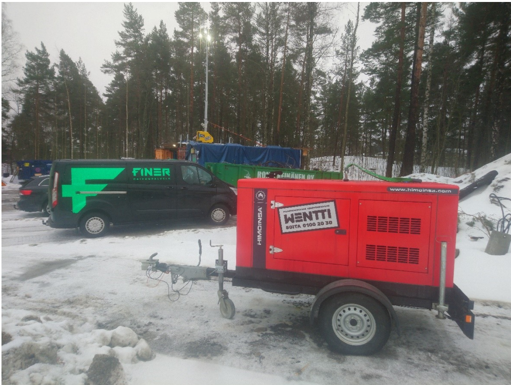
Kuva 6 Varavirtalähteenä käytettävä Himoinsa, 40 kVA aggregaatti
