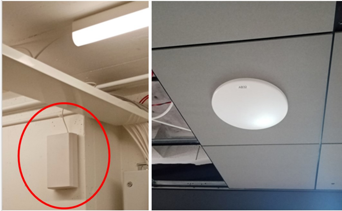
KUVA 6. Vasemmalla seinälle asennettu suuntaava paneeliantenni ja oikealla ympärisäteilevä lautasantenni alakattolevyssä
