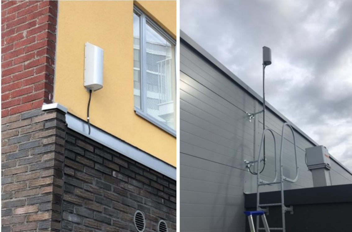
KUVA 8. Kahden rakennuksen virve-toistimien sieppausantennit seinälle ja mastoon asennettuna
