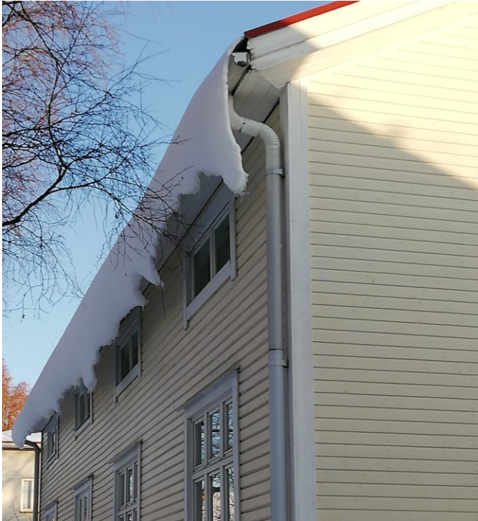
KUVA 17 Lumi roikkuu vaaraa aiheuttaen
