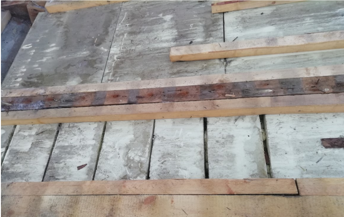
KUVA 8 Havaittiin, että aikaisempi välipohjan tuuletusväli oli ollut riittämätön.
