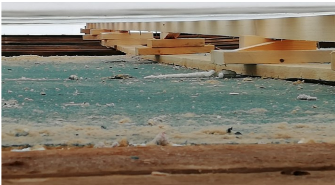
KUVA 18 Alusta epätasainen ja heikosti kiinnitetty
