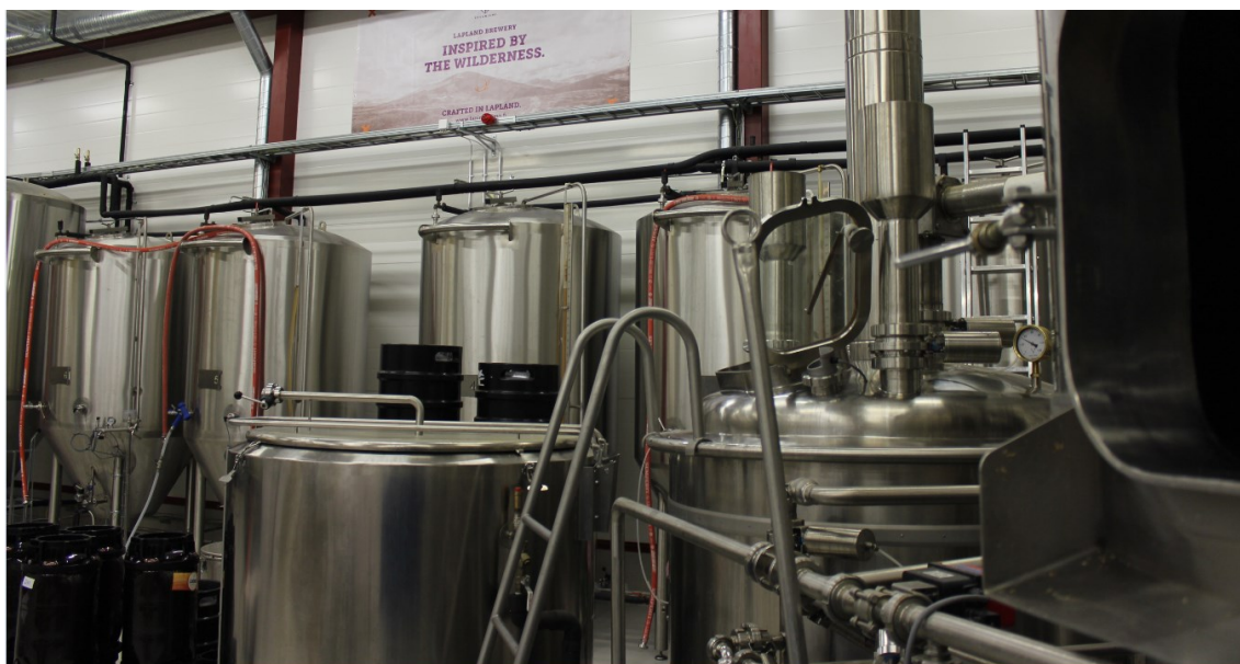
Kuva 12. Kuvassa vasemmalla nähtävissä Lapin Panimon keittolaitteisto ja taustalla painetankkeja.
