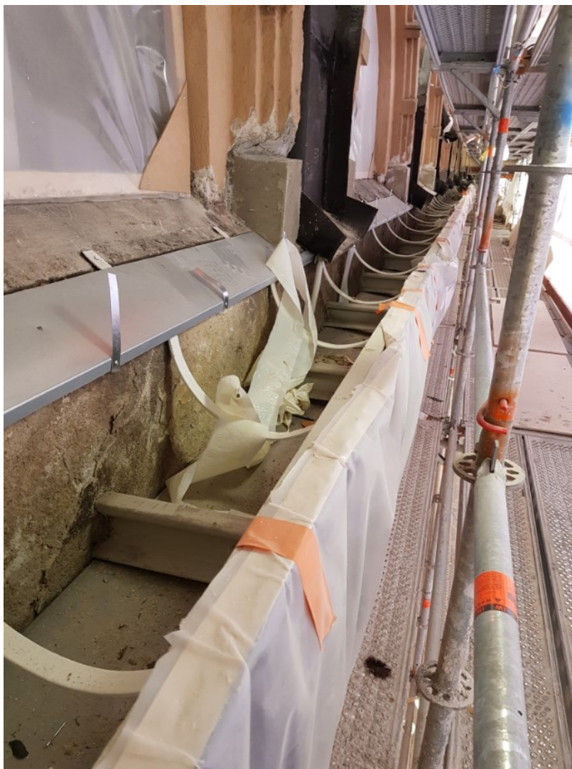
Kuva 21. Vesikourun kannattimet maalattu ruosteenestomaalilla
