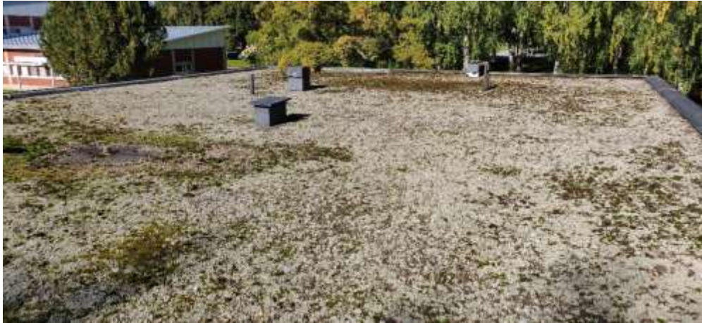
Kuva 3. Katon sammaloituminen. Jonne Koivumäki (2020-08-21)
