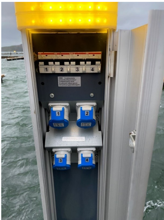
Kuva 3: Airiston venesataman laiturin sähköpylväs, jossa on 4x16A paikkoja. (Kuva: Kari Suonsilta)
