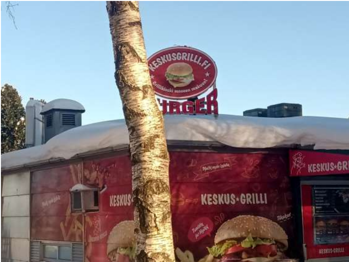
KUVA13. Keittiön huippuimuri vasemmalla puolella ja huuvan huippuimurit oikealla puolella.
