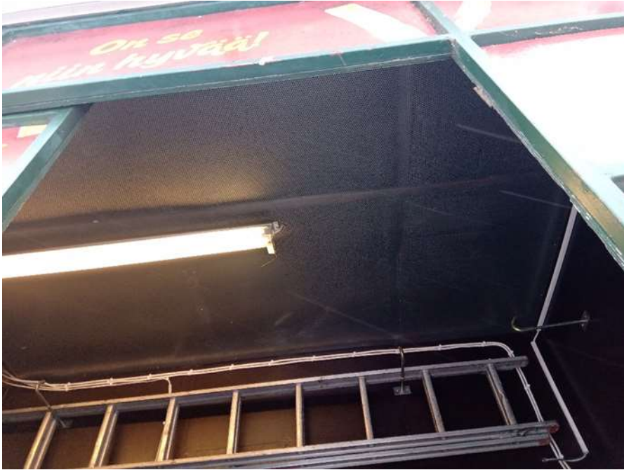
KUVA 8. Ulkovaraston sisäänkäynnin kattoon sijoitettu ulkoilmaritilä.
