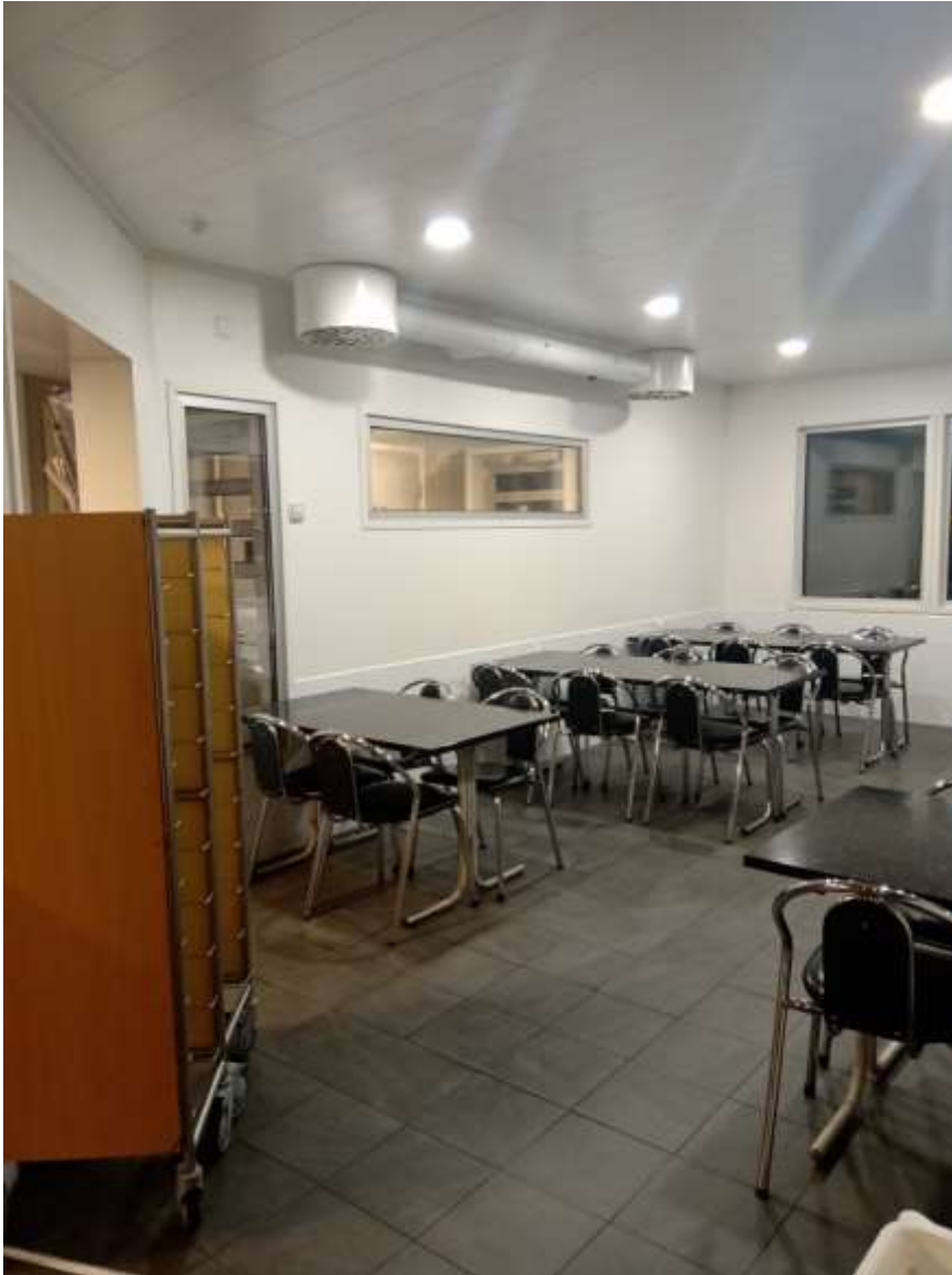
KUVA 28. Uuden asiakaspuolen tuloilmahajottajat
