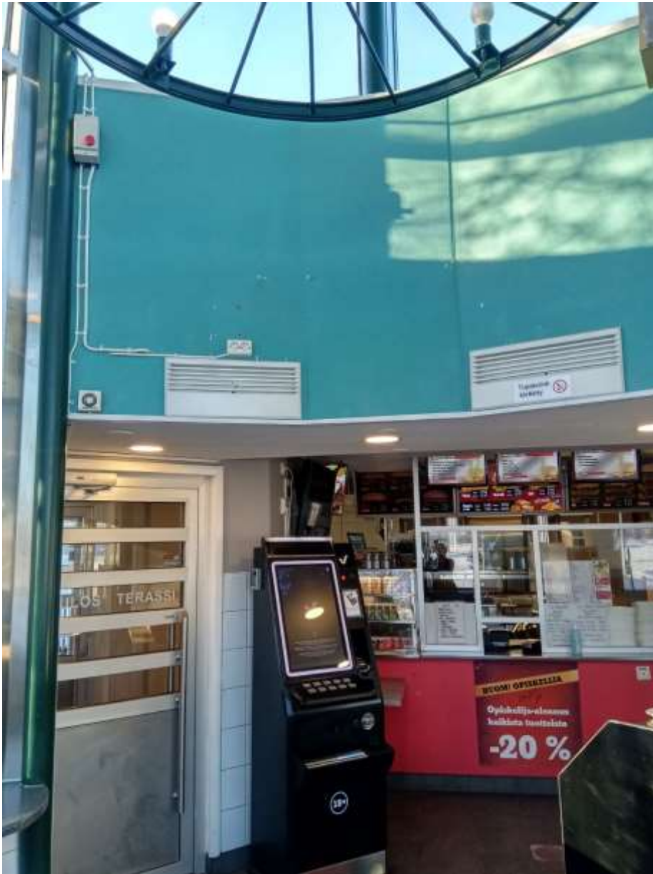
KUVA 30. Tornin tuloilmalaitteet, vasemmassa yläreunassa tornin lämmittimien käynnistyskytkin
