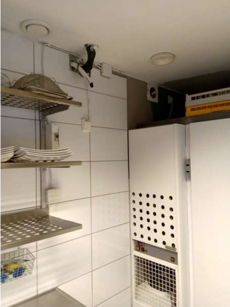
KUVA 22. Keittiön tulo- ja poistoilmapäätelaitteet
