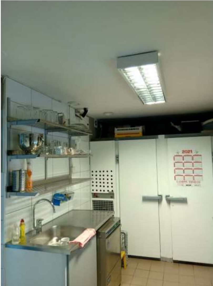
KUVA 24. Keittiön pakastin ja kylmähuoneet sekä astianpesukone. Vasemmalla puolella nurkassa on pakastimen lauhdutinyksikkö.
