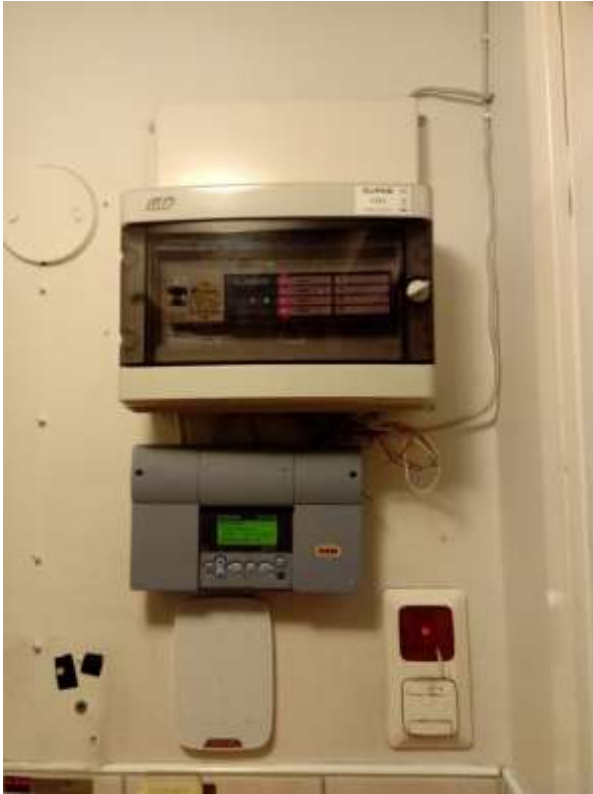
KUVA 17. Ouman- ilmastoinninsäädin sekä ohjaus- ja valvontayksikkö, oikeassa alareunassa pariloiden kytkin.
