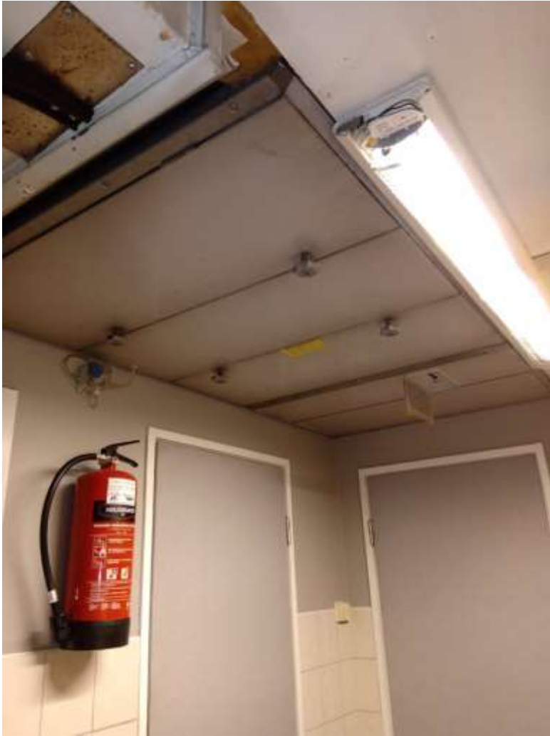
KUVA14. Tuloilmakone apukeittiön katossa
