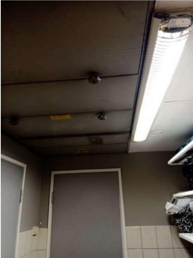
KUVA 27. Apukeittiön poistoilmapäätelaitte valaisimen oikealla puolella
