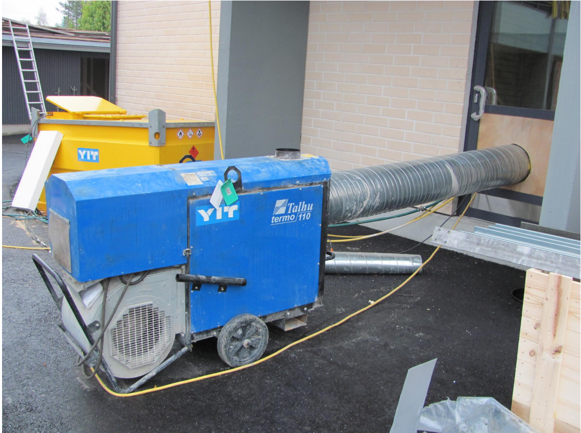
Kuva 30. As Oy Rajakiven kerrostalon Talhu termo 110 -öljylämmitin ja 2000 l öljysäiliö lämmitin takana.
