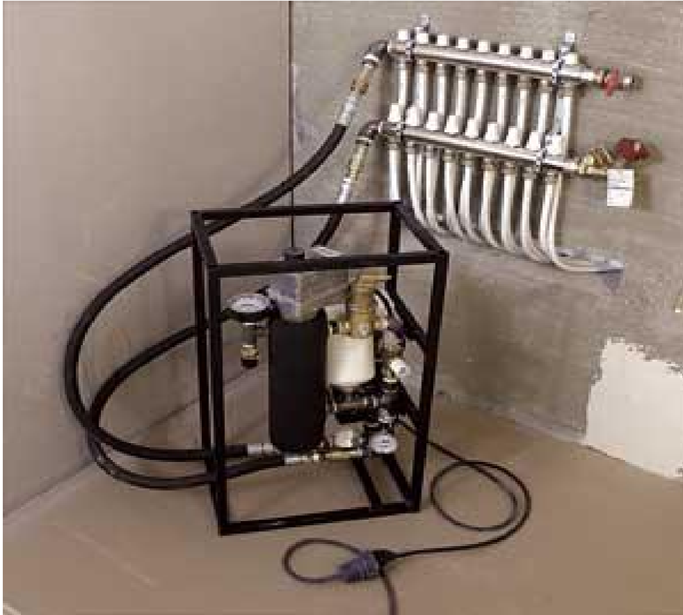
Kuva 28. Tempo kuivalämmittimessä käytettävän 10 % vesi-glykoliseoksen ansiosta ei lattia lämmitysjärjestelmässä käytettävä seos pääse jäätymään vaikka joku ottaisi talvella lämmittimen vahingossa pois päältä (Puronlahti 2012; Reditalot 2012).
