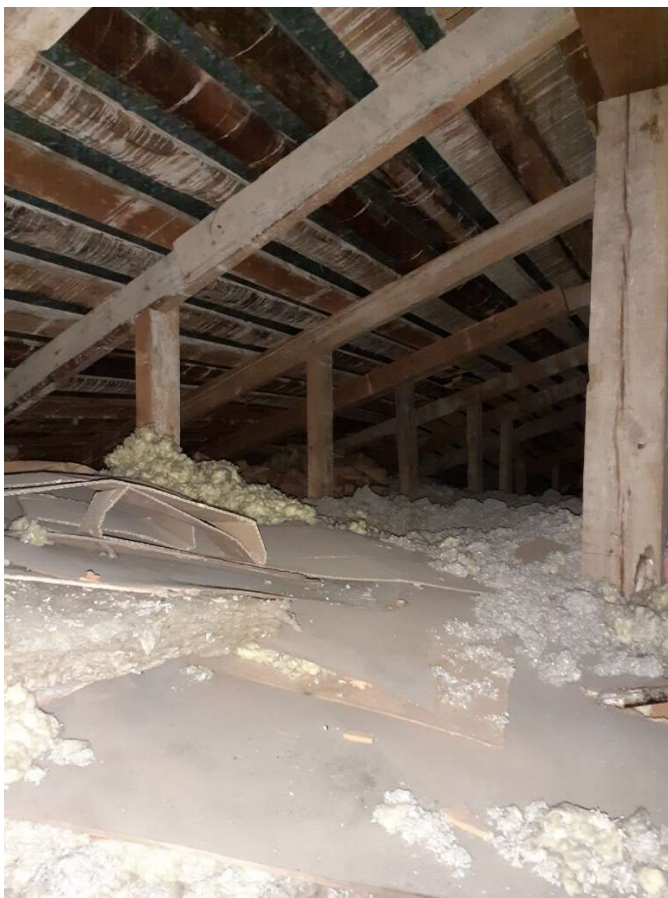
Kuva 16. Koskikadun rakennuksen läntisen osan yläpohjalla vanhaa puhallusvillaa
