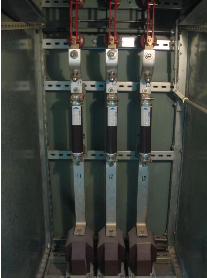
KUVA 6. Jännitemuuntajia ja suurjänniteputkivarokkeita SA1B1:ssä (Sami Suhonen 2012)
