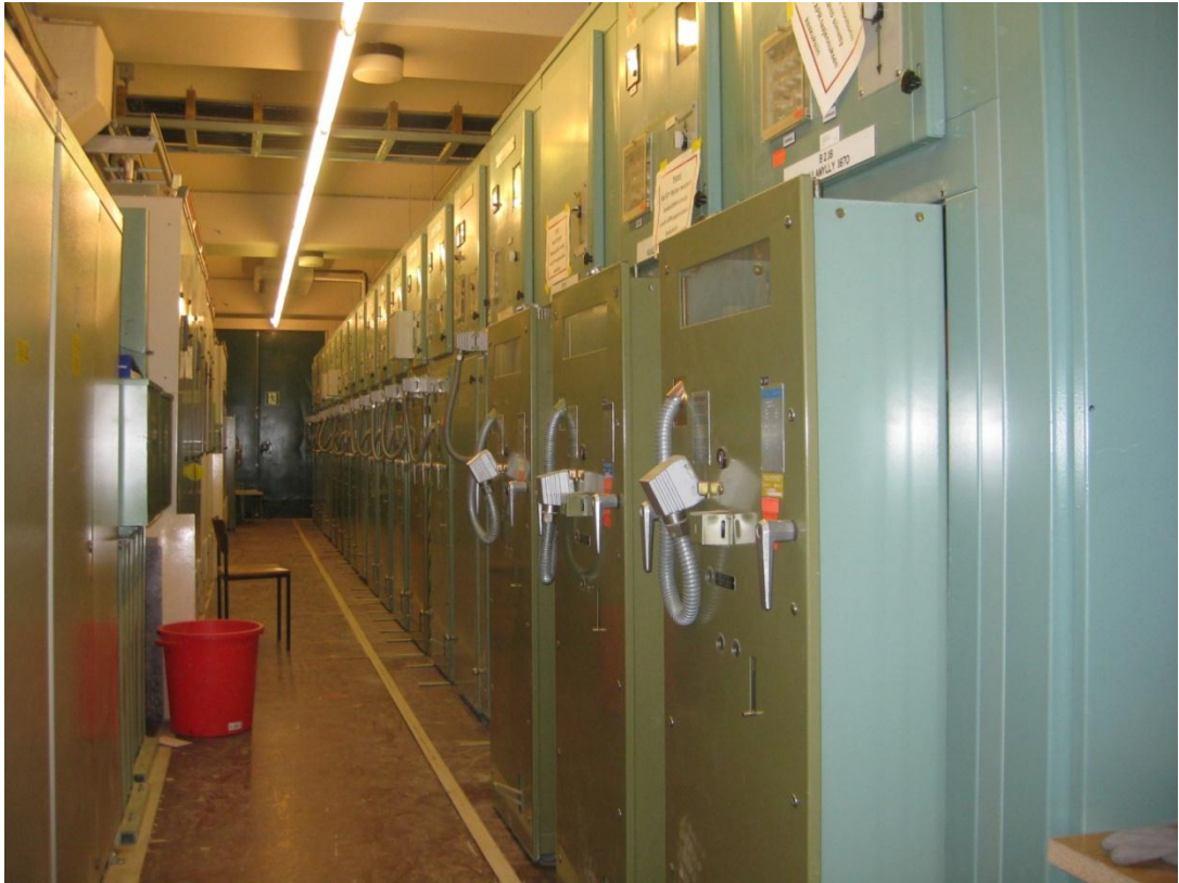
KUVA 81. KAB3 ja KAB2 rikastamon 10 kV:n sähkötilassa (Sami Suhonen 2012)
