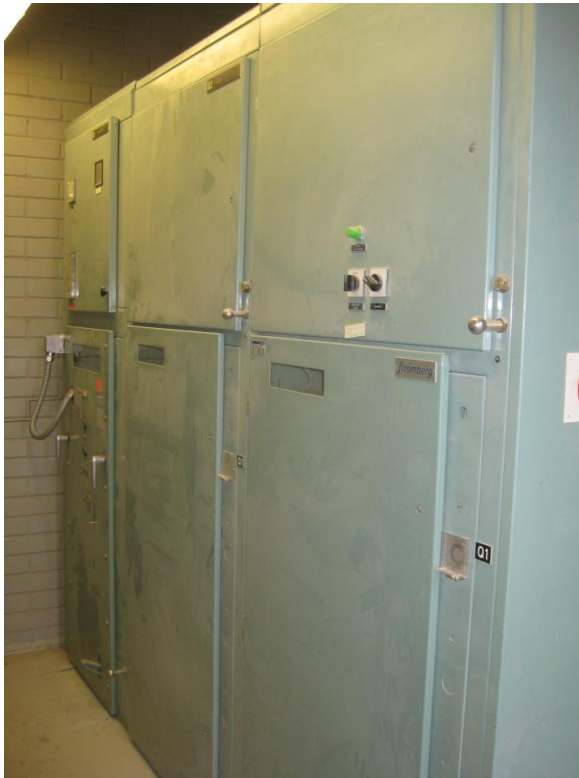
KUVA 92. KAB4 risteysaseman 10 kV:n sähkötilassa (Sami Suhonen 2012)
