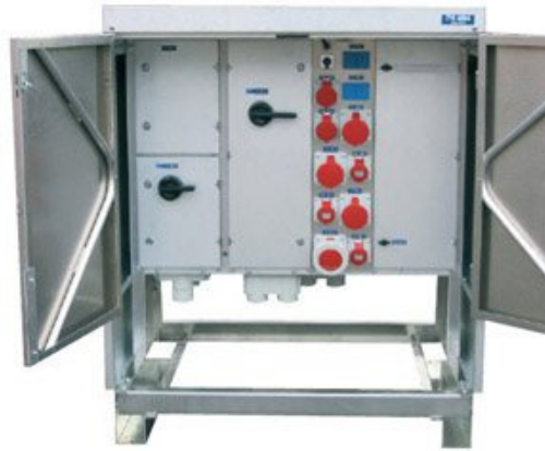
Kuva 4. Sähköpääkeskus TPK 400A [1].
