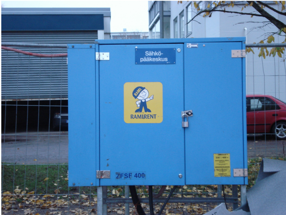
Kuva 9. Sähköpääkeskus, As Oy Helsingin Yliskylänpuisto
