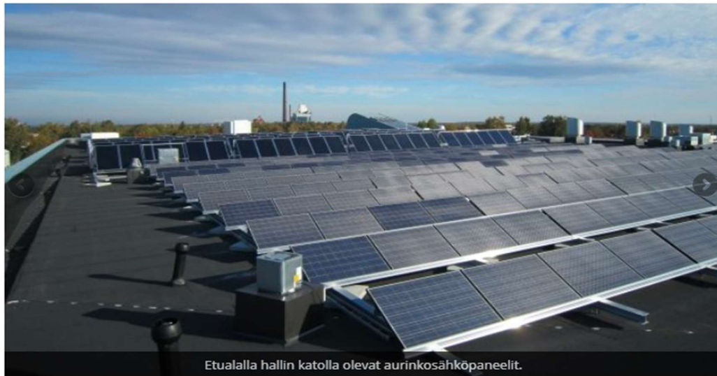
Kuva 8. Porin uimahallin aurinkopaneelit ja aurinkokeräimet taustalla (Solarforum 2011).
