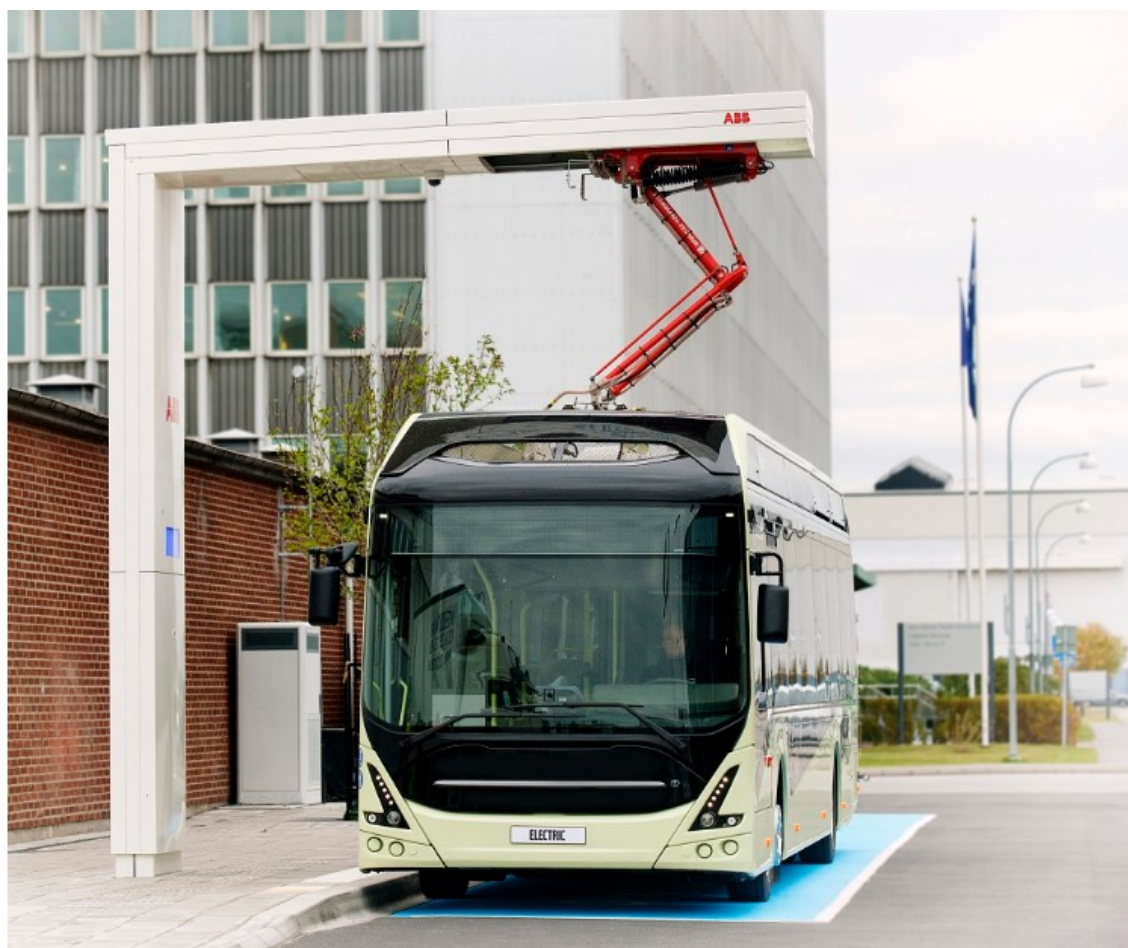
Kuva 14. ABB:n kiskolatausjärjestelmä. Ajoneuvon katolla latauskoskettimet liitetään toisiinsa [21].
