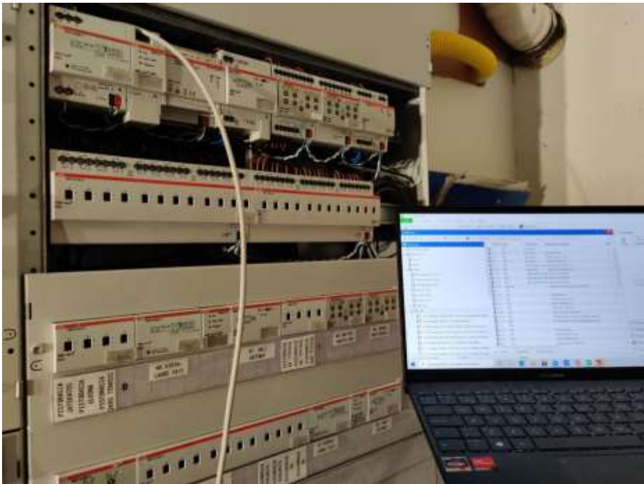
KUVA 18. ETS yhdistetään KNX-keskukseen.
