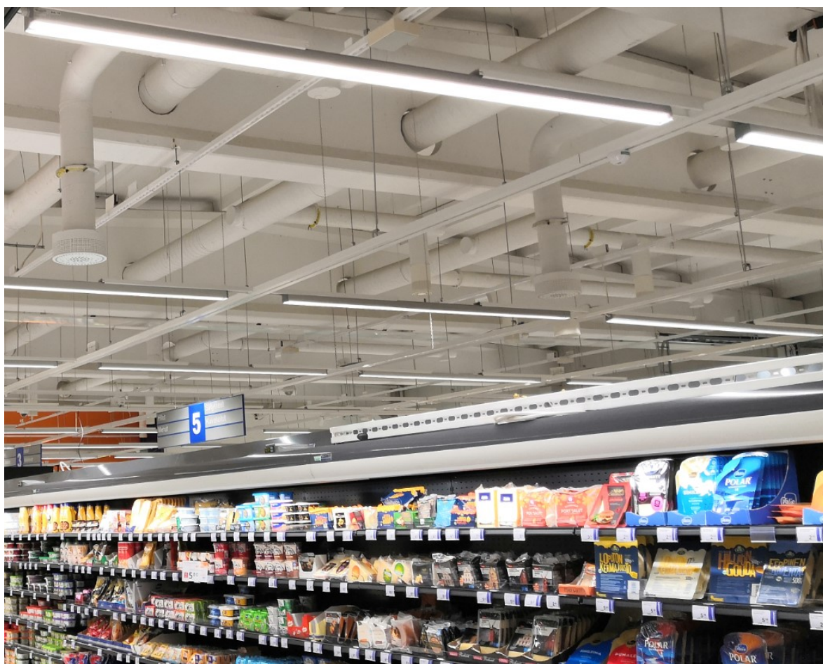
Kuva 15. Snep Mode C-valaisin asennettuna myymälään
